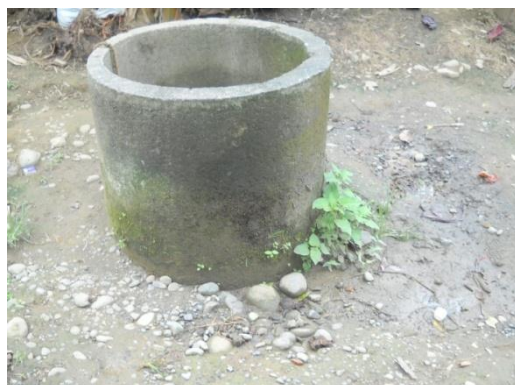
Figura 15. Pozo sin ningún tipo de protección. Sin brocal, sin acera y además es agua es extraída con una cuerda que se contamina cada vez que toca al suelo.
