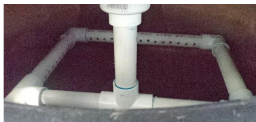
Figura 28. Dispositivo de aireación dentro del tanque #1.
