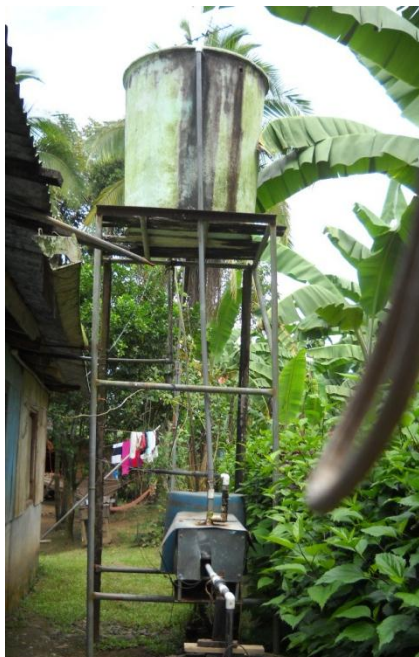
Figura 16. Tanque de almacenamiento de agua sin ningún tipo de protección en su parte superior (la bomba y el pozo se observan abajo).
