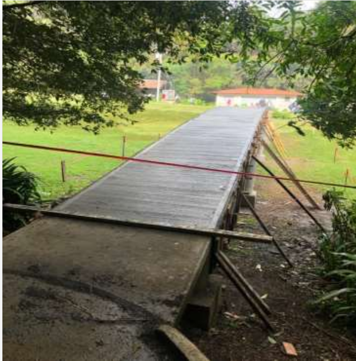
Fotografía. Construcción de rampa para mejorar el acceso en el Paradero Turístico Monte de La Cruz. (Villalobos, 2020)
