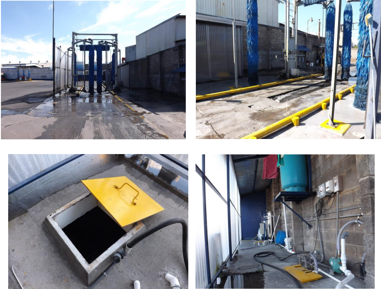
Figura N° 12 Instalaciones de lavado automatizados con sistema de recirculación y purificación de aguas
