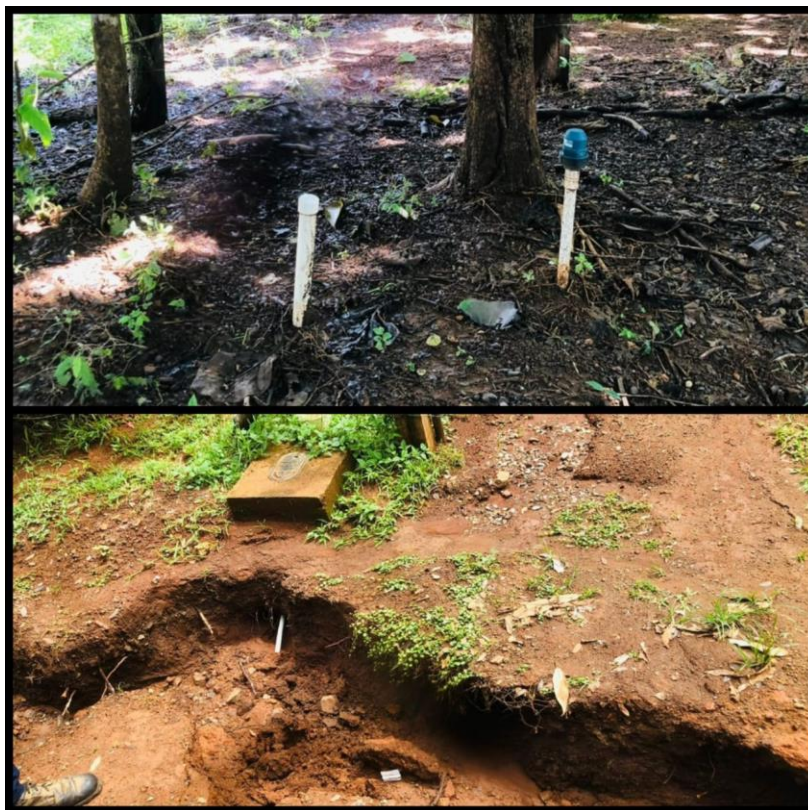
Figura 23 Tubería expuesta en el sector Paraíso.
