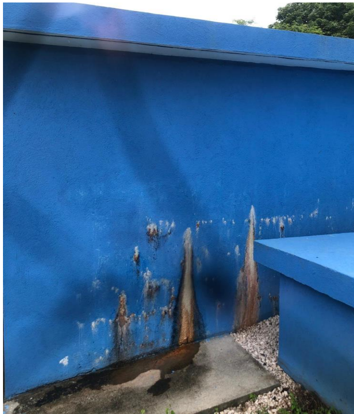
Figura 26 Filtraciones en el Tanque 3 Sector Pargos-Lagartillo. Fuente: Elaboración propia, 2022.
