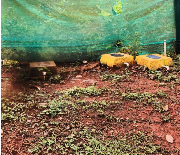
Figura 19 Tubería expuesta en los micromedidores. Elaboración: Propia, 2022.
