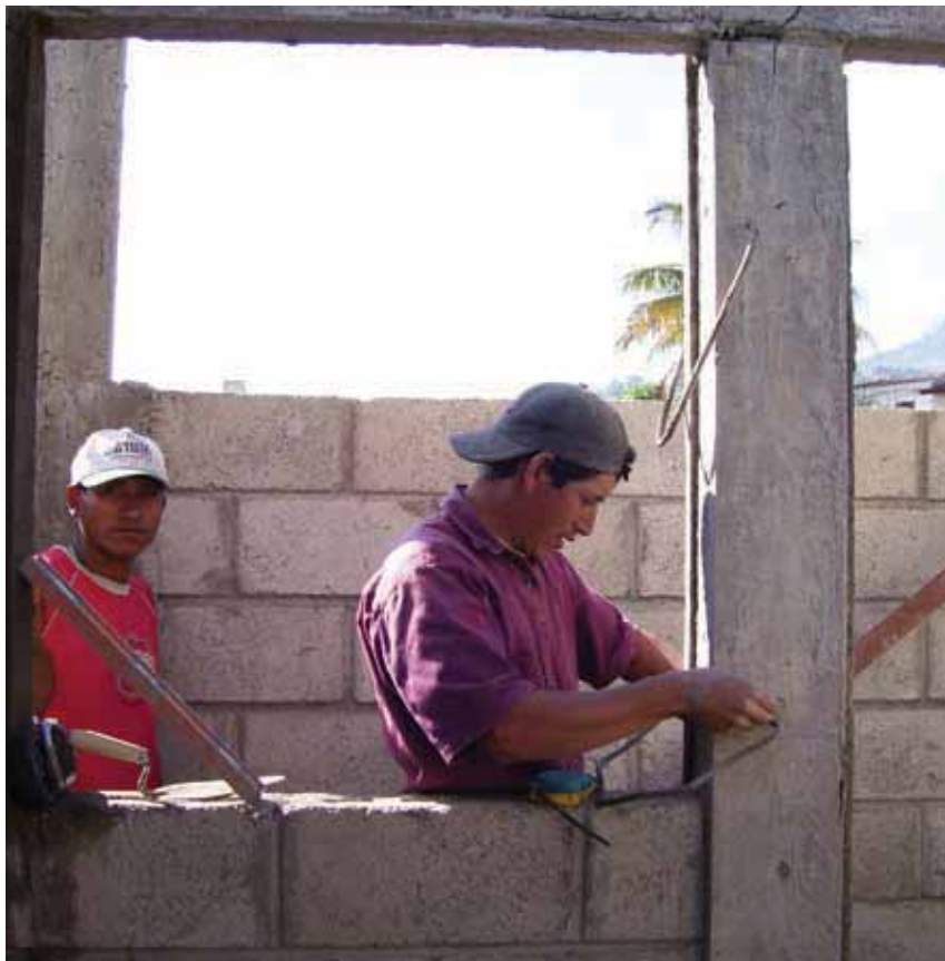
Trabajadores del sector informal sin equipos de protección. Proyecto de residencia Ramírez Vázquez, Tegucigalpa.
