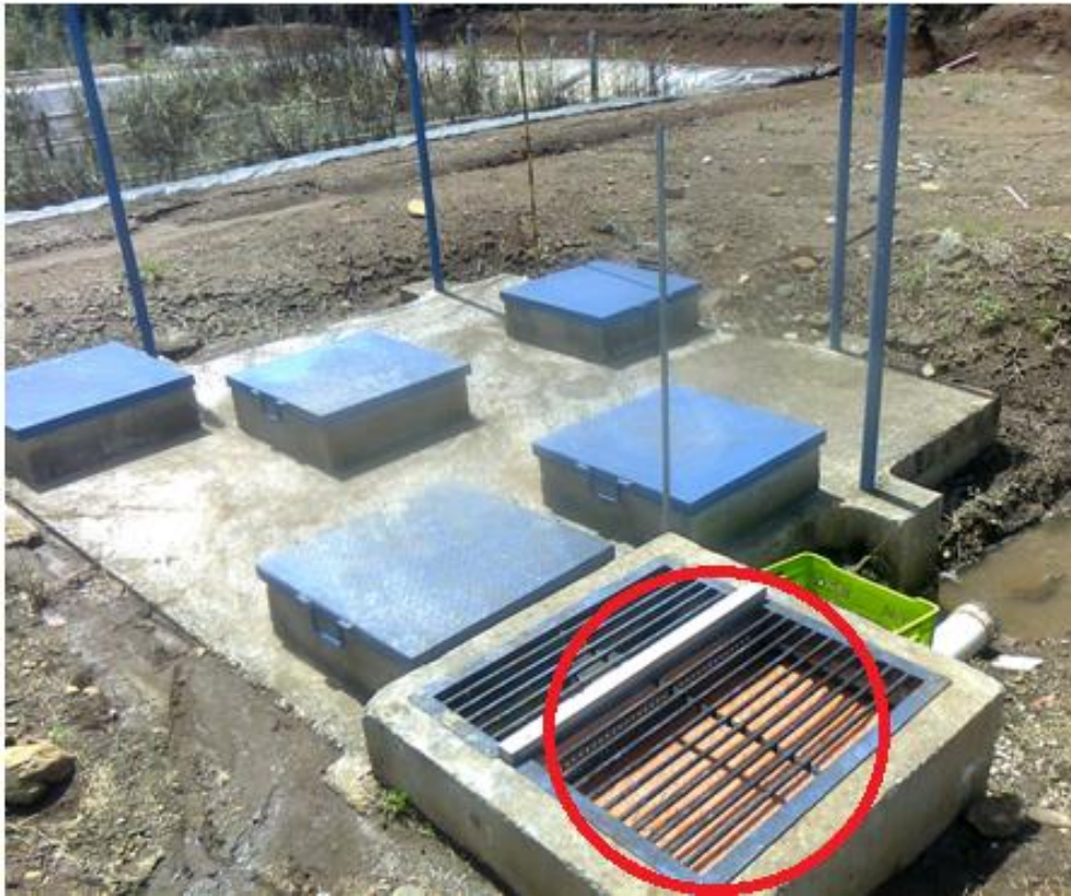
Figura 14. Tercer cenicero ubicado en la entrada de la PTAR con presencia de residuos sólidos orgánicos provenientes de la Planta de Pulpas y Congelados.
