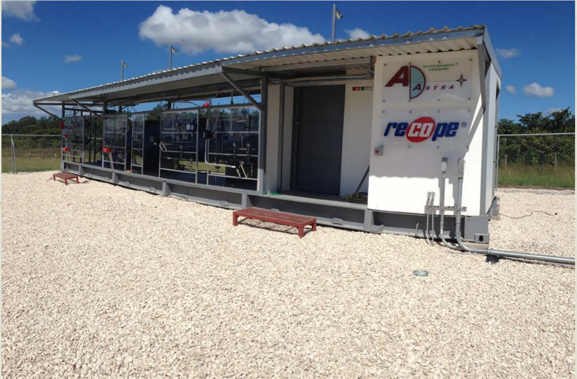
Figura 2. Planta experimental de producción y almacenamiento de hidrógeno, propiedad de Recope y desarrollada en conjunto con Ad Astra Rocket Company Costa Rica.
