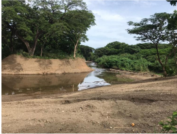
Imagen 4. Estado actual del segundo sector crítico producto de la socavación de la calle 3 en Santa Bárbara, Santa Cruz, Guanacaste.
