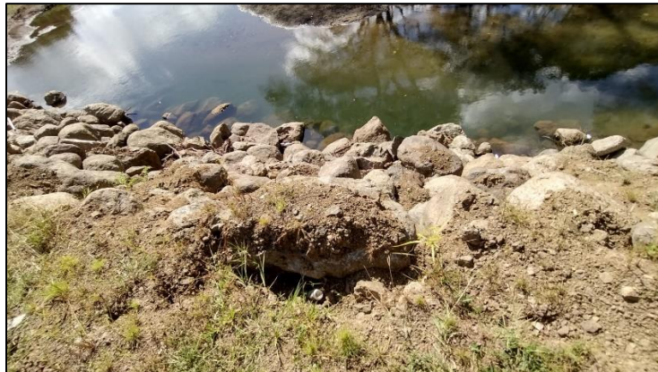
Imagen 23. Desprendimiento del enrocado por acción de la escorrentía superficial y la fuerza hidráulica del río Santa Bárbara.
