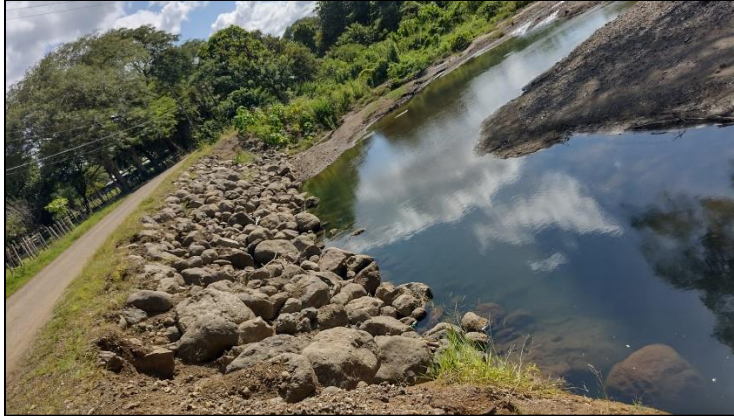
Imagen 22. Protección temporal de enrocado elaborada como medida a corto plazo para combatir la socavación de la carretera y abrir el paso.
