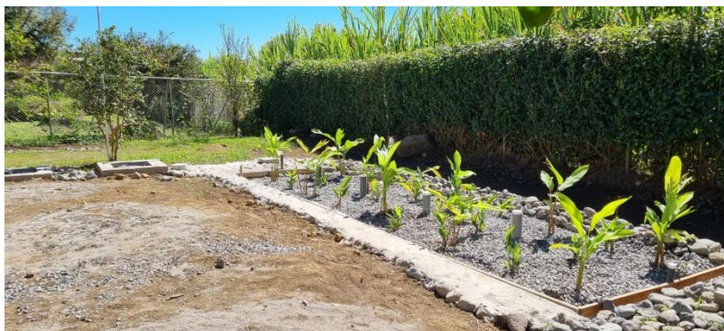
Figura 16. Humedal artificial de flujo subsuperficial horizontal.
