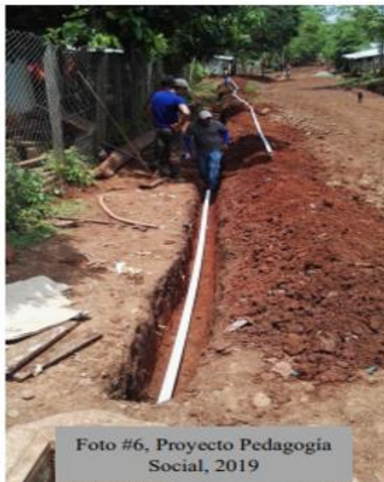
Figura 140. Tubos de distribución. Elaboración del Proyecto Pedagogía Social, 2021
