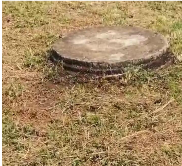
Figura 99. Tanque séptico lleno en la comunidad del Triunfo, cada vez que ingresan nuevas aguas negras estas se desbordan. Tomada por Meléndez (2021).
