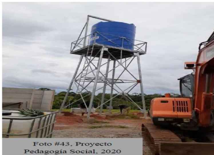
Figura 200. Tanque de almacenamiento del pozo de agua. Elaboración del Proyecto Pedagogía Social, 2021
