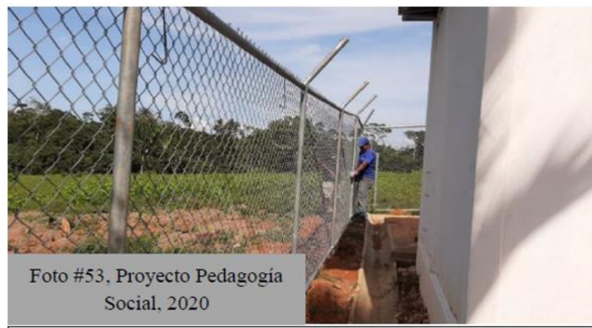
Figura 202. Colocación de malla perimetral en la zona del tanque. Elaboración del Proyecto Pedagogía Social, 2021
